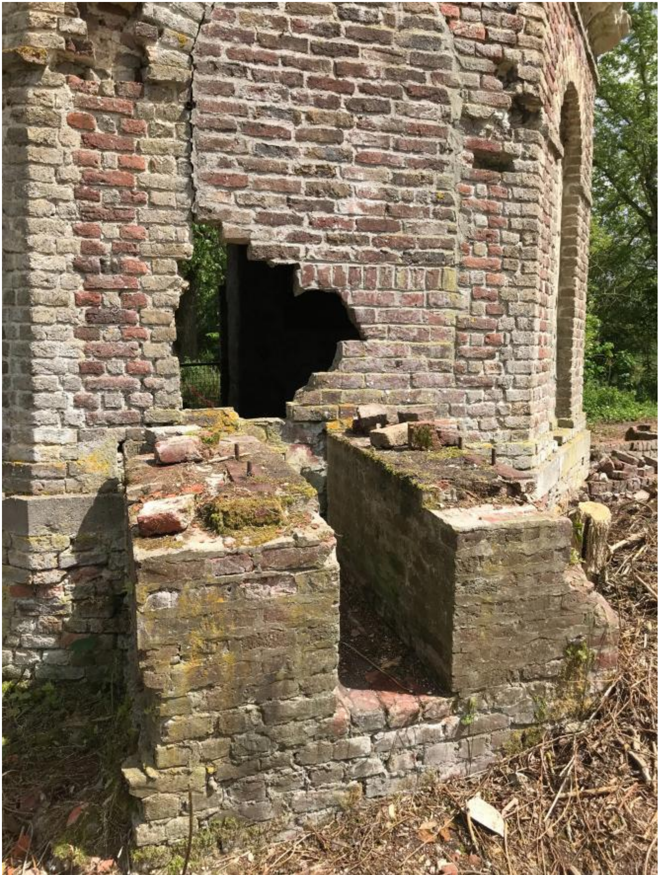
La goulotte par laquelle la vis entraînait l'eau vers le canal.
